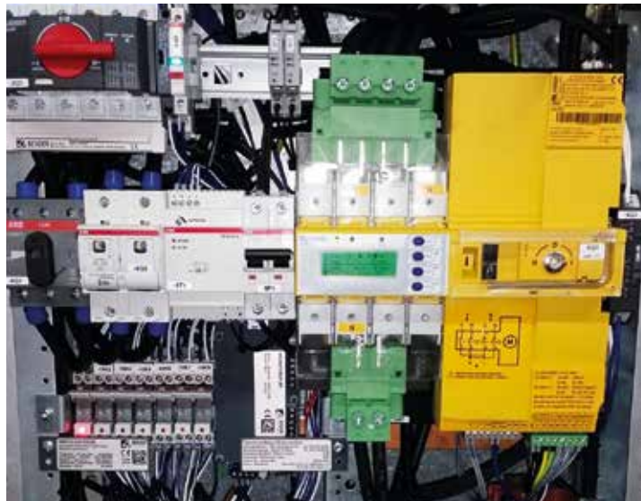
In den Verteilern sind TÜV-geprüfte, automatische Umschaltgeräte mit Überwachung für ungeerdete Sicherheitsstromversorgungen vom Typ ATICS®-2-63A-ISO im Einsatz.
